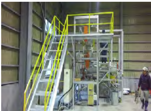
図2 連続式の過熱水蒸気炭化炉
