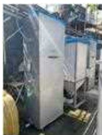
(写真) 県内企業に設置されたパイロットプラント
