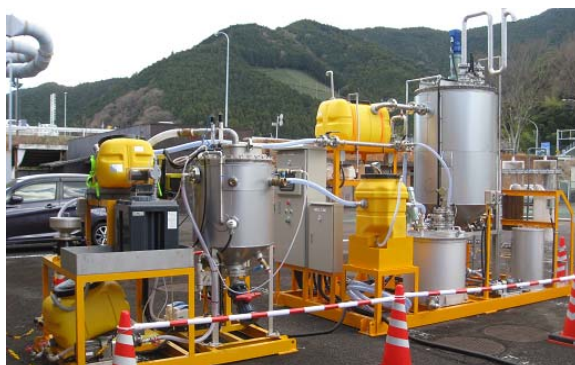
図1 メタン発酵パイロットプラント
