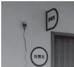
図2 施設に設置したZigBee無線中継器
