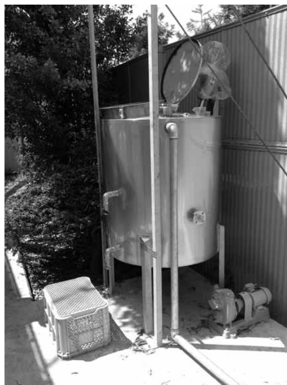
写真1 油前処理装置
