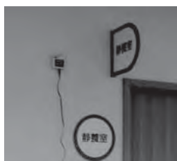
図2 施設に設置したZigBee無線中継器
