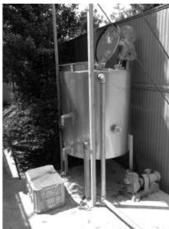
写真1 油前処理装置
